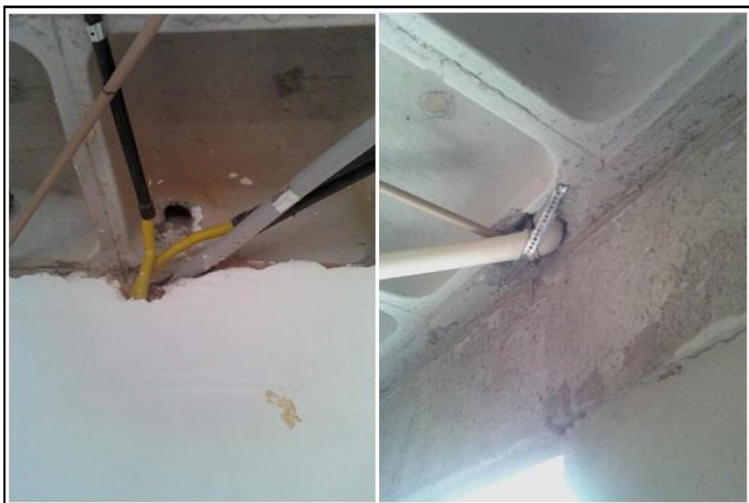
Figura 10 - Conflito entre estrutura de concreto e instalações hidrosanitárias (SOUZA, 2010)
