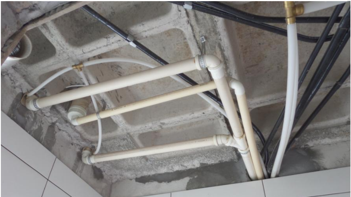
Figura 53 - Interferência anterior na Obra A
