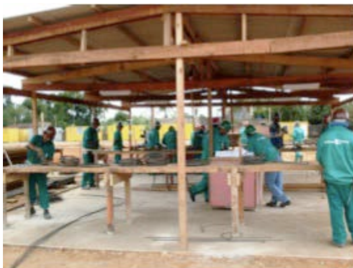
Figura 31: Central de Armação (FREITAS, 2011)
