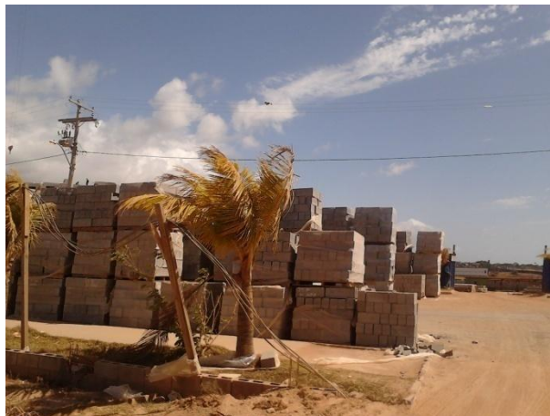
Figura 42 - Armazenagem de blocos por resistência em paletes.
