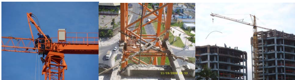
Figura 05. Imagens na utilização da grua com risco de acidente.
