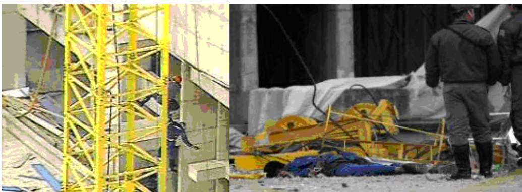
Figura 03. Corpo de operário morto em acidente com grua em SP.
