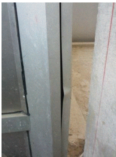
FIGURA 14 • Módulo empenado pelo armazenamento
